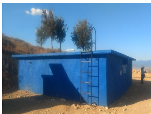
Imagen 49. Tanque de agua superficial en Santa Cecilia Jalieza. Fuente: Propia autoría.
