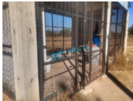
Imagen 44. Pozo de agua profunda en la localidad de Santo Tomás Jalieza. Fuente: Propia autoría.
