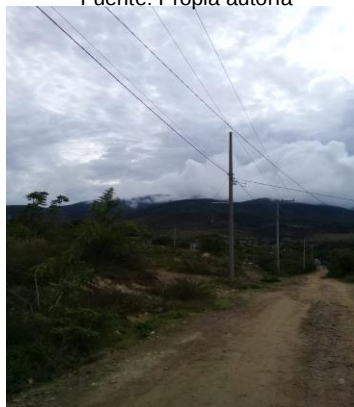
Imagen 33. Red de distribución de energía eléctrica en Santo Tomás Jalieza Fuente: Propia autoría
